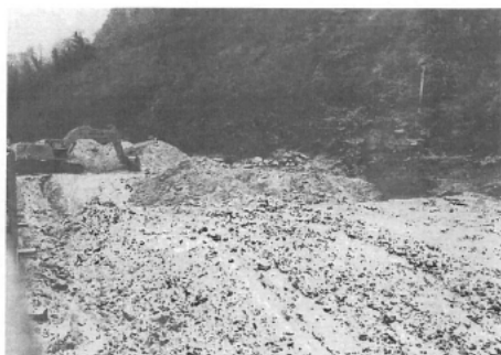
Reichlich Erde bewegt haben die Gfrörer-Bagger für das Hauptgebäude des neuen Angelika-Wössner-Stifts. Je nach Witterung sollen die Arbeiten nächste Woche fortgesetzt werden. Bild: Cristina Priotto
